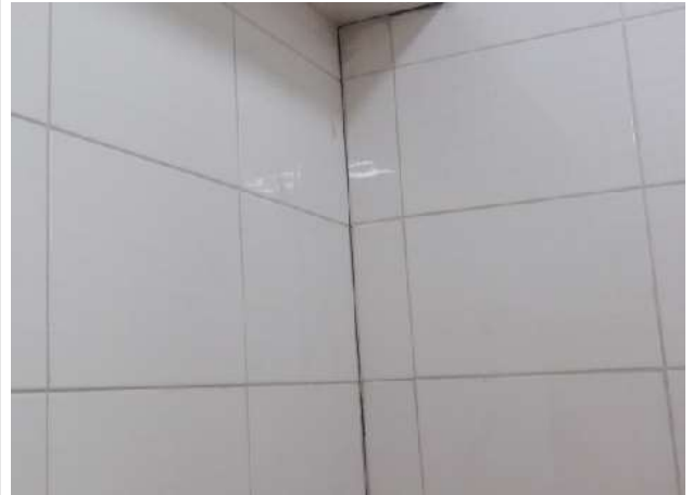
건축물 옥탑층 타일마감 이격
