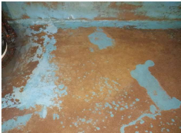
흡수정 2지 하부슬래브 도장박리, 박락
