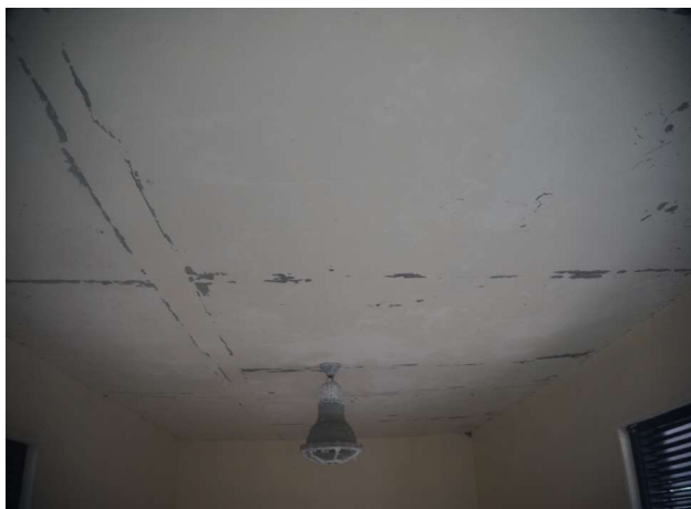
계단실 내부 상부슬래브 도장박리
