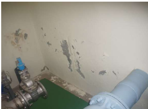
펌프실 지하1층 벽체 도장박리, 박락
