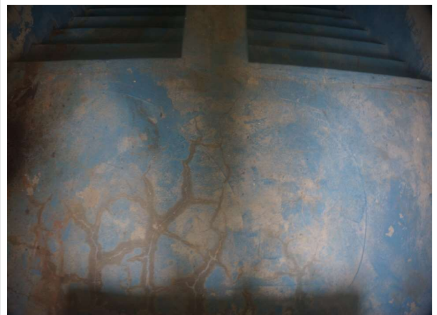
계단실 내부 바닥슬래브 망상균열
