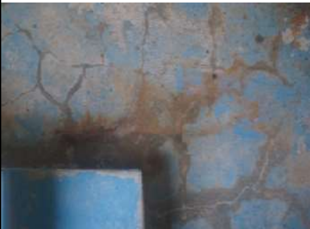
계단실 내부 바닥슬래브 도장박리, 박락
