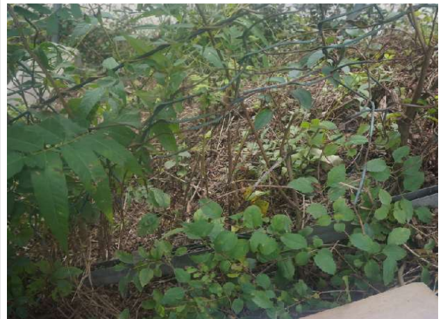
웬스 능형망 파손
