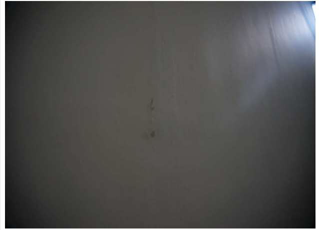
지하1층 펌프실 벽체 도장박리
