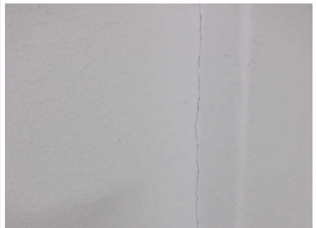
건축물 옥탑층 벽체 이질재 접합부 이격
