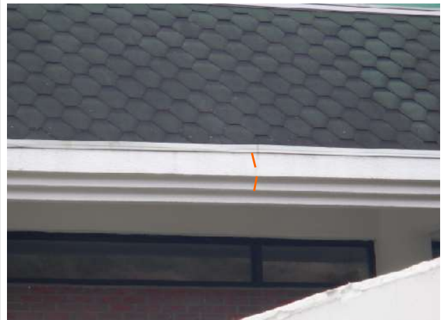
지상1층 펌프실 외부 파라펫 균열(0.3mm미만)
