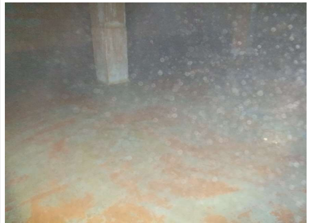
흡수정 2지 하부슬래브 도장박리, 박락
