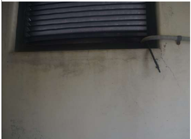
계단실 내부 벽체 모르타르 균열(0.3mm미만)
