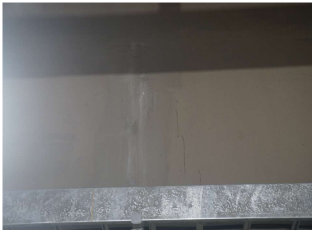
유입밸브실 내부 벽체 백태
