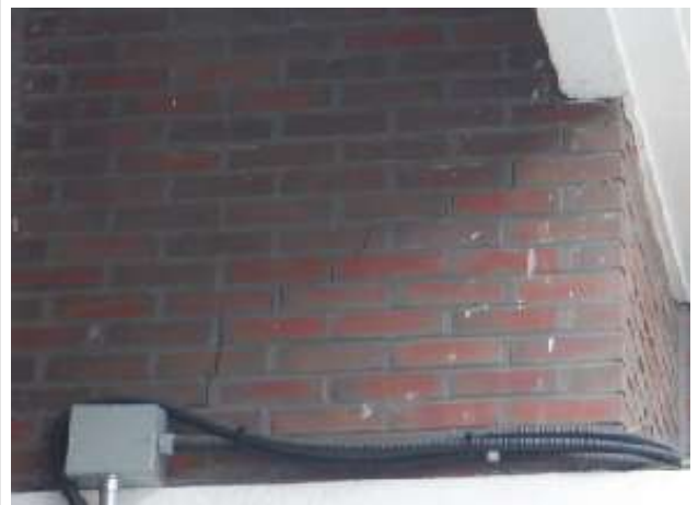
건축물 외부 벽체 치장벽돌 줄눈 균열
