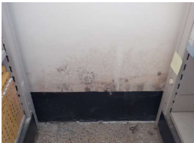
건축물 옥탑층 벽체 누수흔적[몰탈 마감부]
