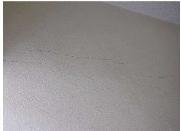
건축물 지상2층 벽체 비내력 벽체 균열(0.3mm이상)
