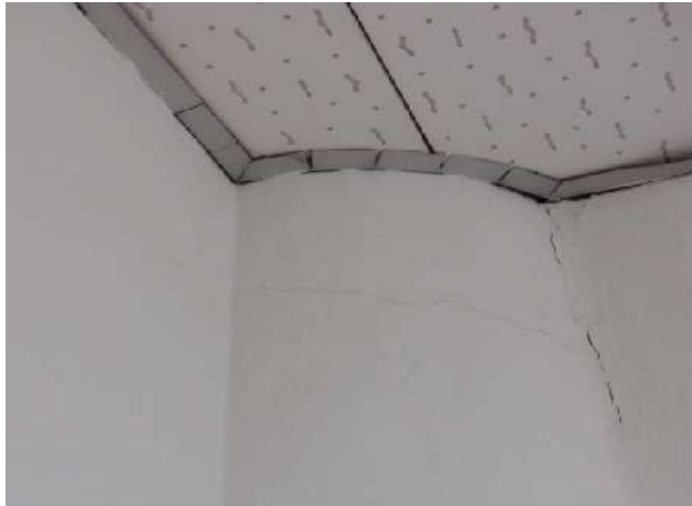
건축물 옥탑층 기둥 몰탈마감 균열(0.3mm미만)
