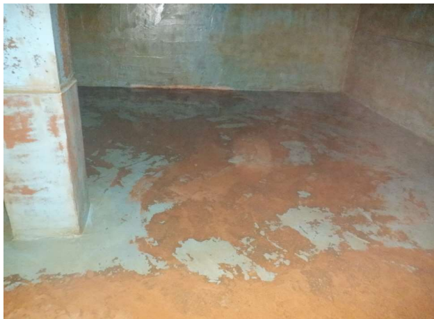
흡수정 1지 하부슬래브 도장박리
