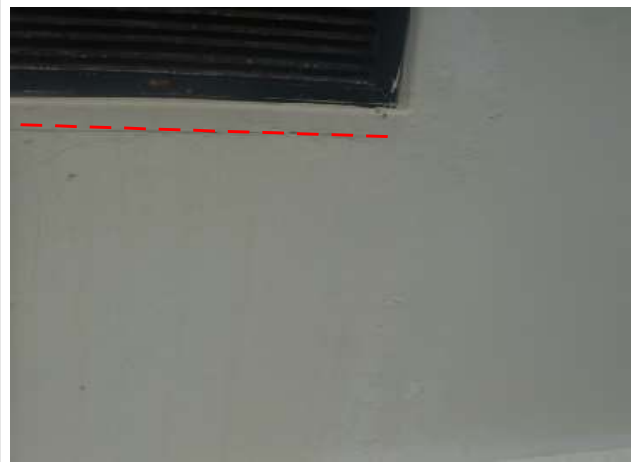
계단실 외부 벽체 균열(0.3mm이상)
