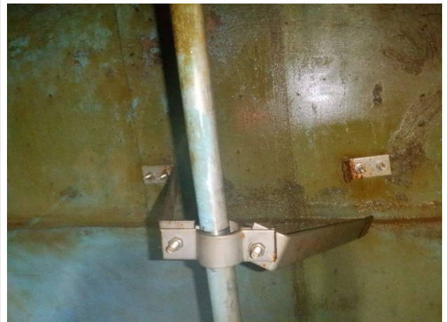
흡수조 1지 스펀들 지지대 파손
