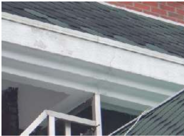
건축물 외부 파라펫 균열(0.3mm미만)
