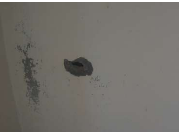
유입밸브실 벽체 마감불량(폼타이홀)
