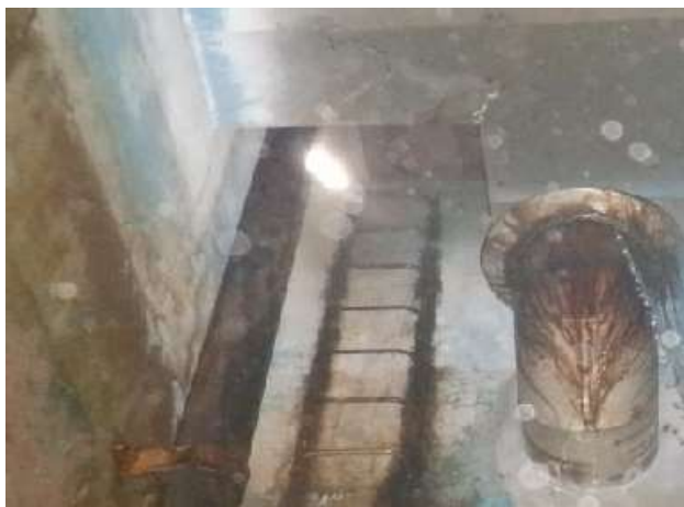
집수정 사다리 부식 및 파손
