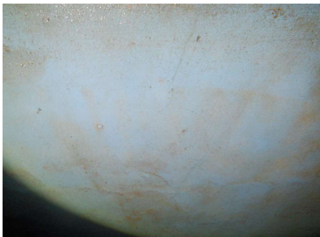
흡수정 2지 벽체 망상균열
