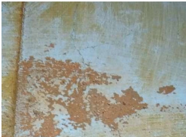
흡수정 2지 벽체 균열(0.3mm미만)
