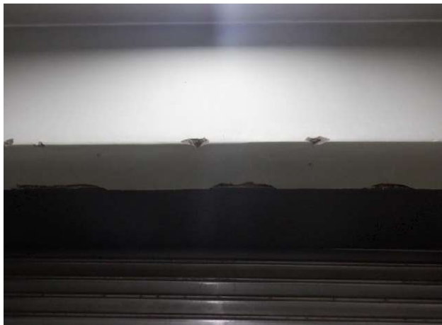
건축물 지상1층 내부 기타부재 물탈박리, 박락
