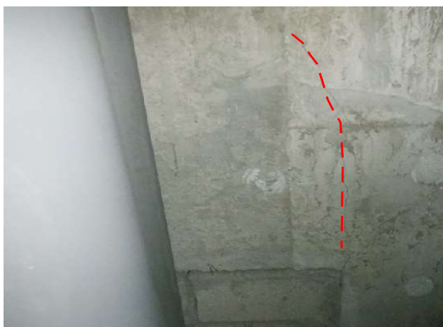
건축물 지상2층 보 균열(0.3mm이상)
