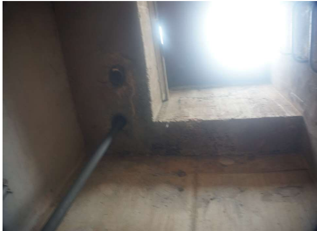
유입밸브실 2지 상부슬래브 재료분리
