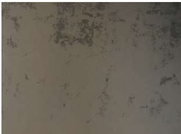
유입밸브실 내부 벽체 도장박리, 박락
