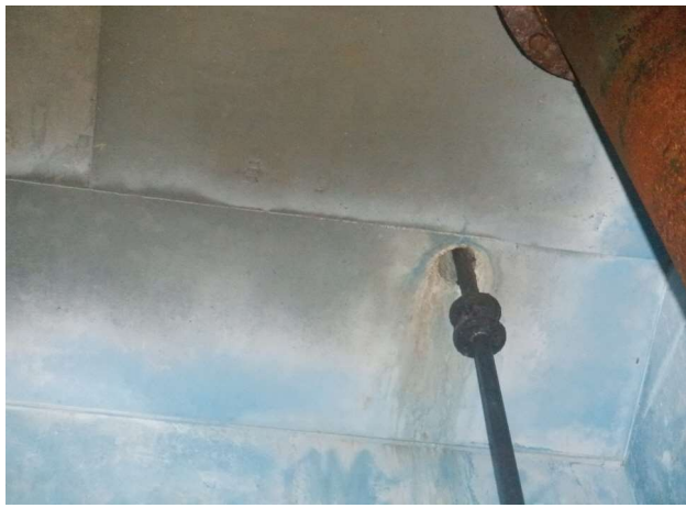
흡수정 1지 상부슬래브 백태
