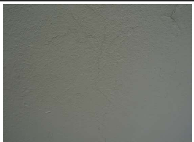
계단실 외부 벽체 균열(0.3mm미만)
