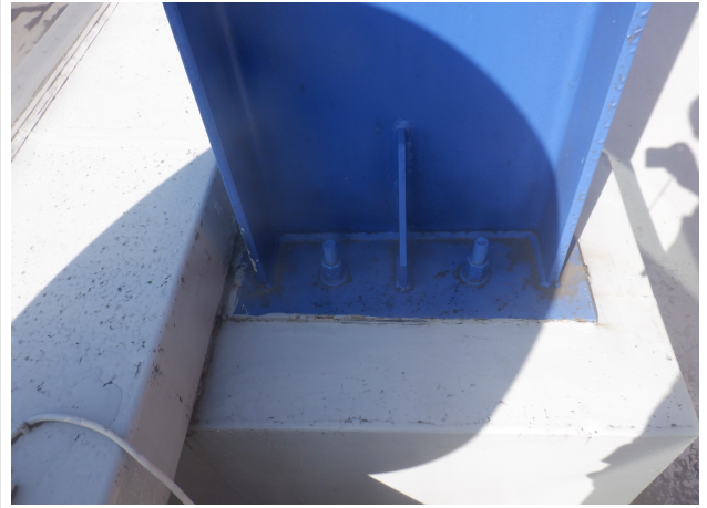
옥탑층 외부 철골부재 접합상태 양호
